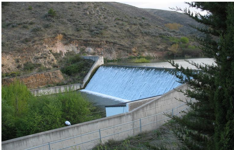
Figura 30-1. Azud de derivación del embalse de El Val.
