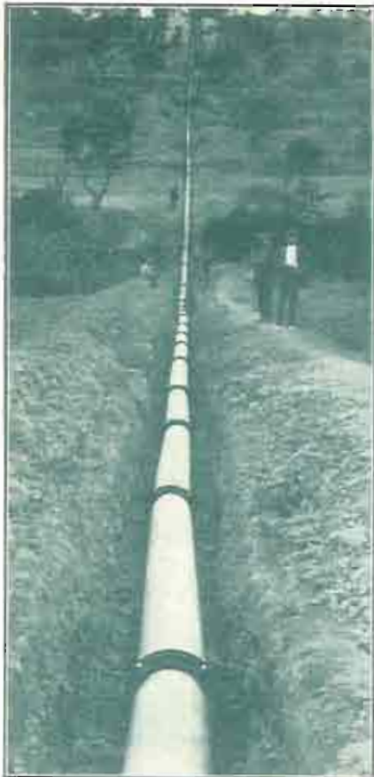
CONDUCCIÓN DE AGUAS EN CERVENA (LHMA) 1063 metros longitud. - 230 mts. diámetro - 10 atmosfères
